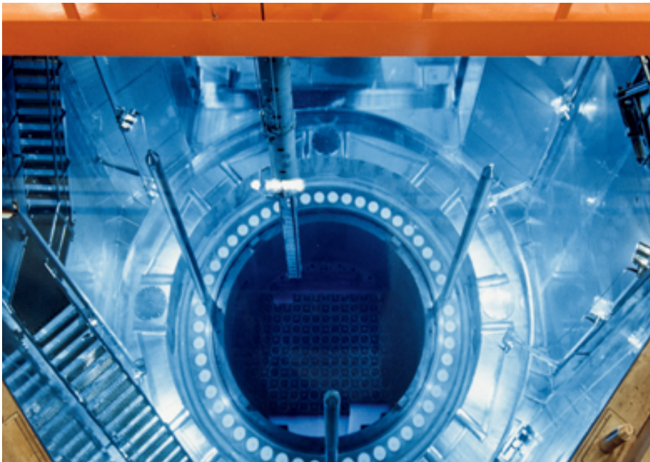
↑ OFFENER REAKTOR: 16 frische Brennelemente wurden während der Revision in den Reaktorkern eingebracht.
